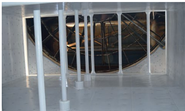
Wykładzina PFA w kanale gazu nieoczyszczonego
