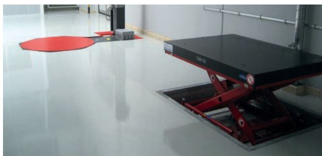
Przewodząca powłoka WHG w hali produkcyjnej
