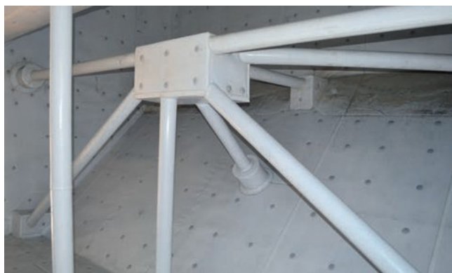
Wykładzina PFA w kanale gazu nieoczyszczonego
