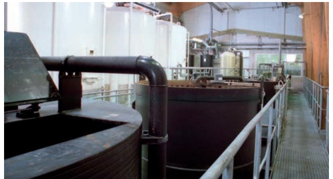
Oczyszczalnia ścieków PE
