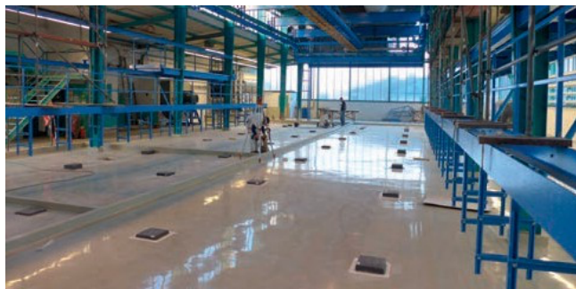
Powłoka WHG zbiornika przelewowego w galwanizerni
